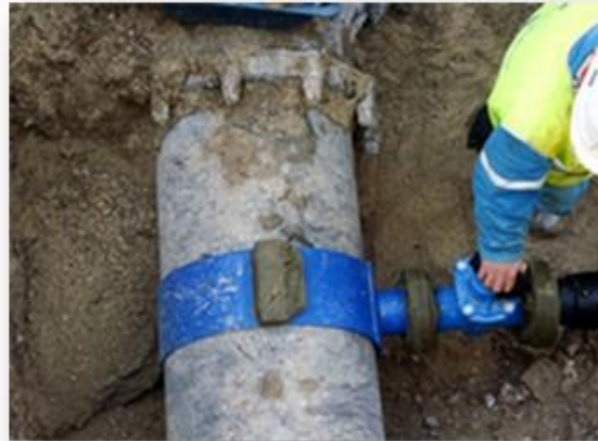
Piquage sur la conduite de réutilisation
