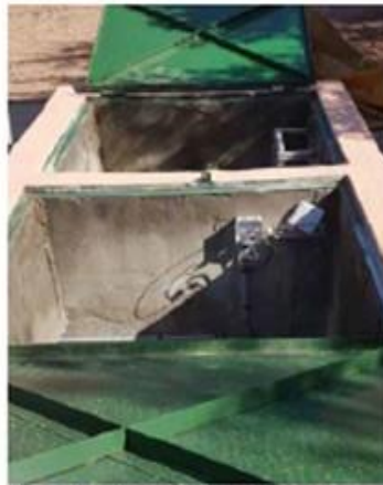
Les bâches enterrées de stockage de l'eau
