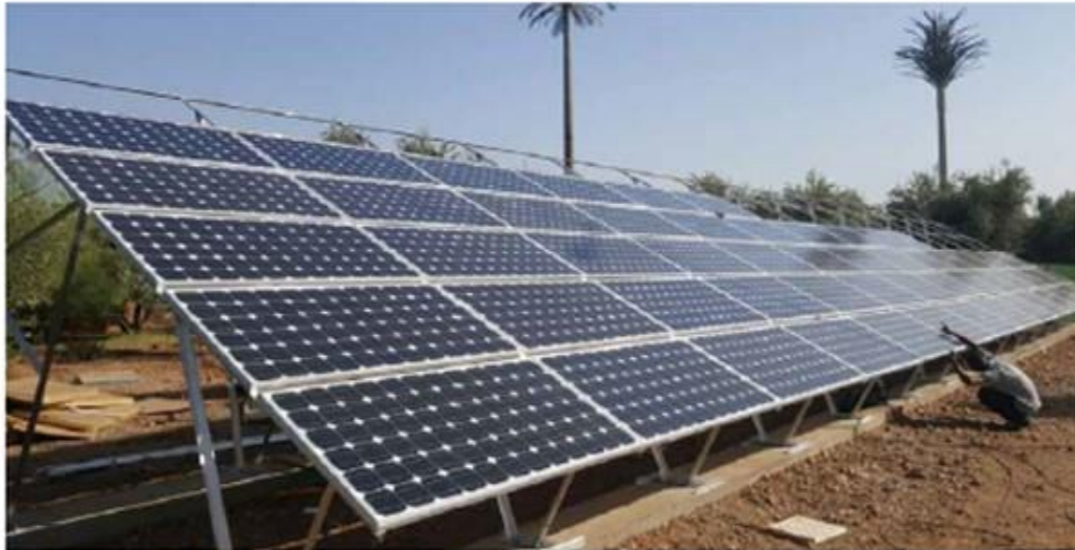
Les panneaux solaires alimentant les pompes
