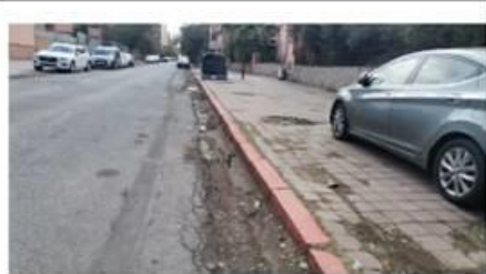
Photos illustrant l'état des voies
